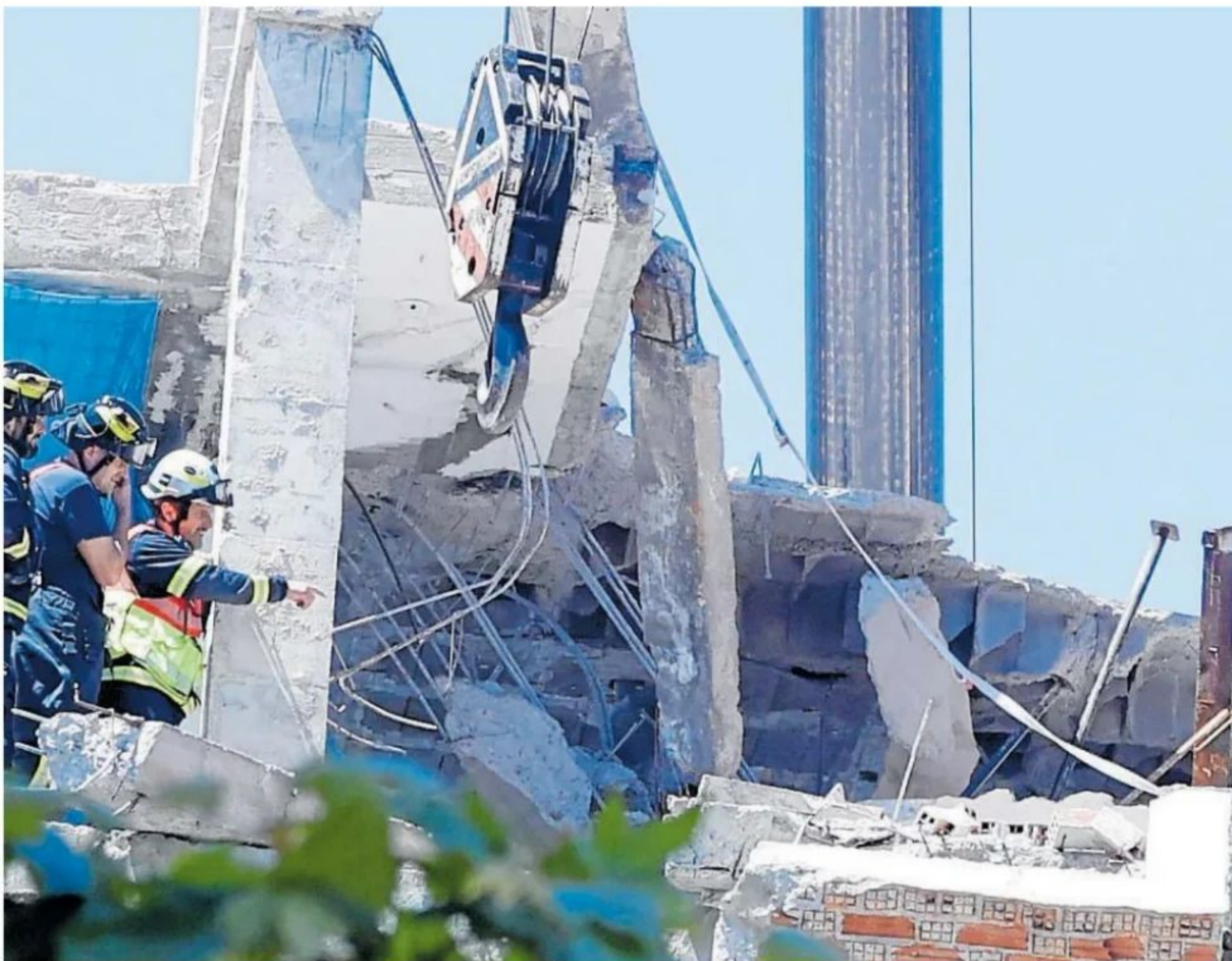
Los bomberos trabajan ayer en la estructura colapsada // AITOR MARTÍN
